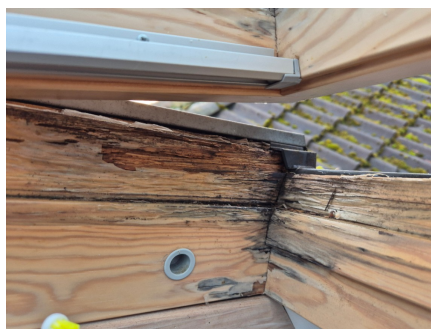
Råte i treverk på bad.
