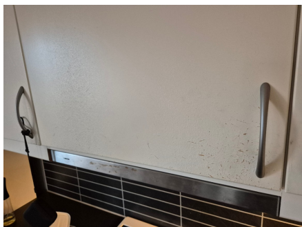
Fuktmerker på front over platetopp.
