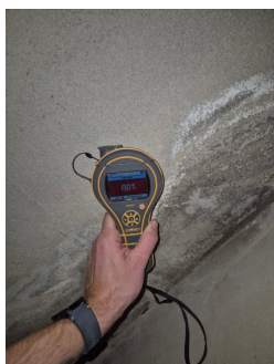
Indikert høye fuktverdier i bod.
