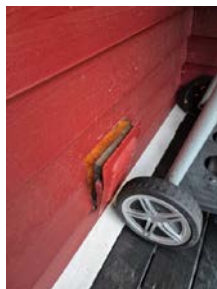
Åpning i vegg tettet med byggeskum.
