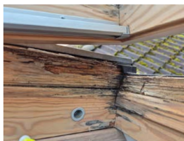
Råte i treverk på bad.
