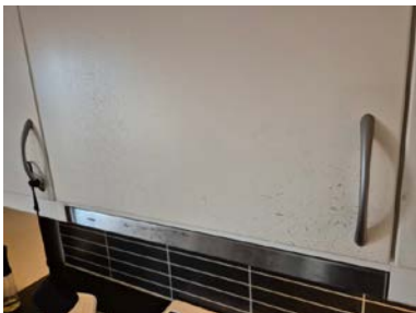
Fuktmerker på front over platetopp.
