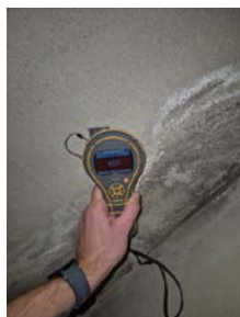
Indikert høye fuktverdier i bod.
