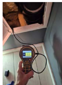
Målt vektprosent på 19,9% i bunnsvill i bod leilighet.
