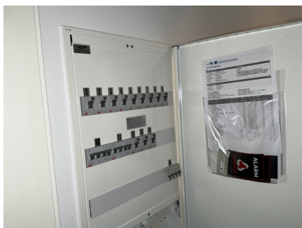
Automatsikringer i sikringsskap plassert i teknisk bod.
