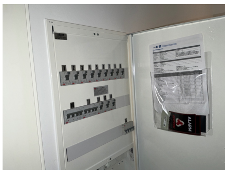
Automatsikringer i sikringsskap plassert i teknisk bod.
