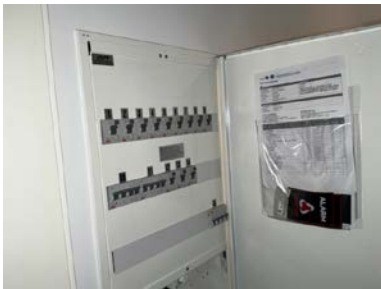
Automatsikringer i sikringskap plassert i teknisk bod.
