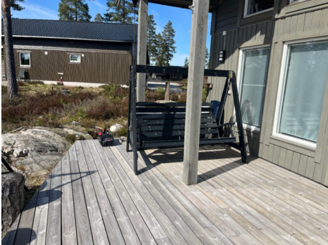
Søyle nærmest er skadet.
