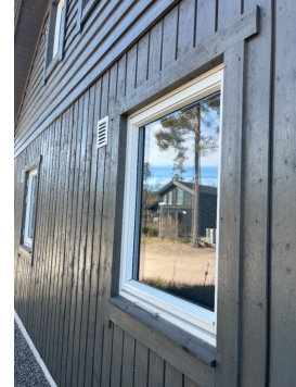
Manglende vannbrett over vinduer, som er utsatt for nedbør.
