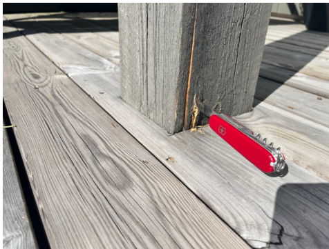
Stikkprøve avdekket skade.
