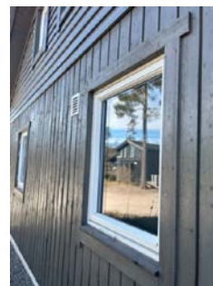
Manglende vannbrett over vinduer, som er utsatt for nedbør.
