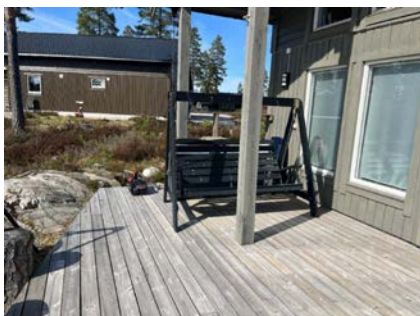
Søyle nærmest er skadet.
