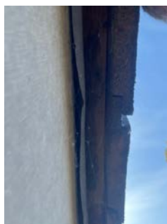
Bilde av underkant kledning uten lufting.
