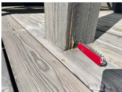
Stikkprøve avdekket skade.
