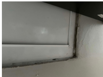
Fordelerskap bak servant på bad 2. etasje
