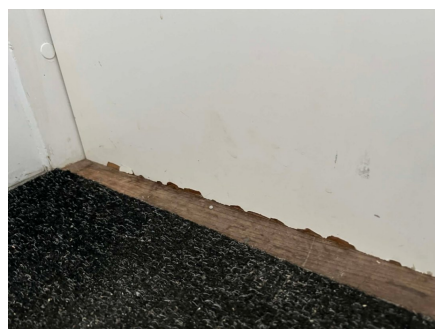
Skader i nedkant av dør
