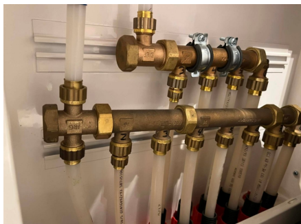
Fordelerskap på vaskerom
