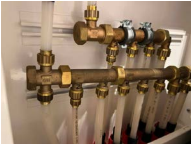
Fordelerskap på vaskerom
