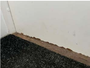
Skader i nedkant av dør
