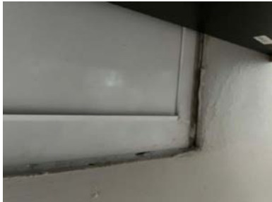
Fordelerskap bak servant på bad 2. etasje
