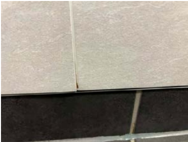
Begynnende fuktskade på baderomsplate
