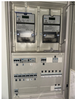
Sikringsskap plassert i felles oppgang.
