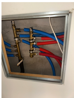
Samleskap med rørkurser og stoppekraner
