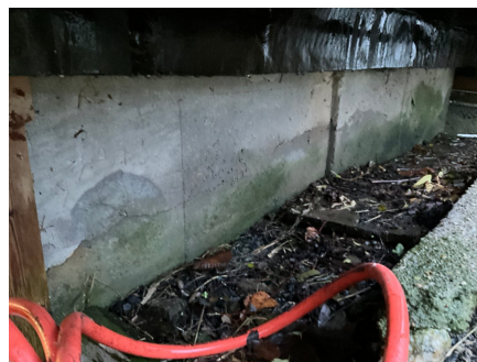
Ingen utvendig fuktsikring.
