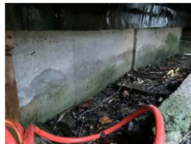
Ingen utvendig fuktsikring.
