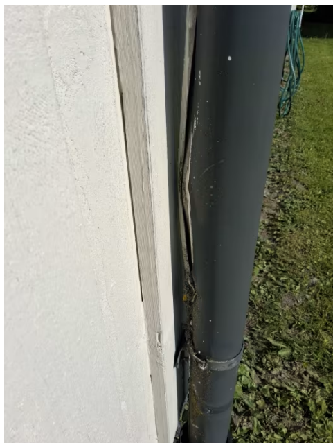
Utbuling på nedløpsrør.
