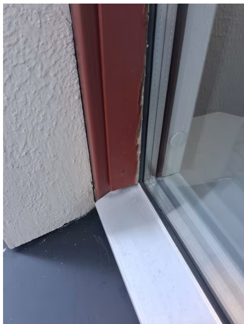
Enkelte vinduskarmer er værslitt.
