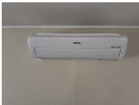
Varmepumpe er plassert i stue.
