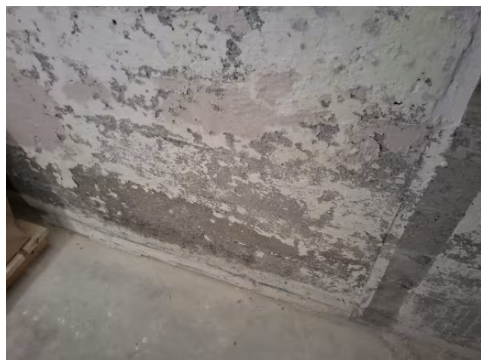
Salt/kalkutslag på grunnmur.
