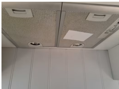
Avtrekkseffekten er testet med papir.
