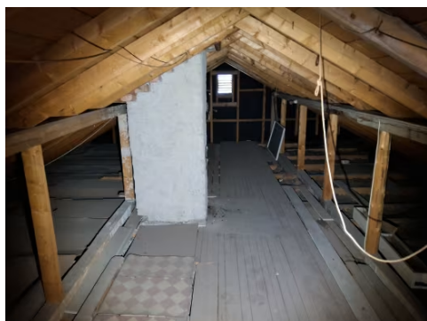
Kaldloft over boligen.
