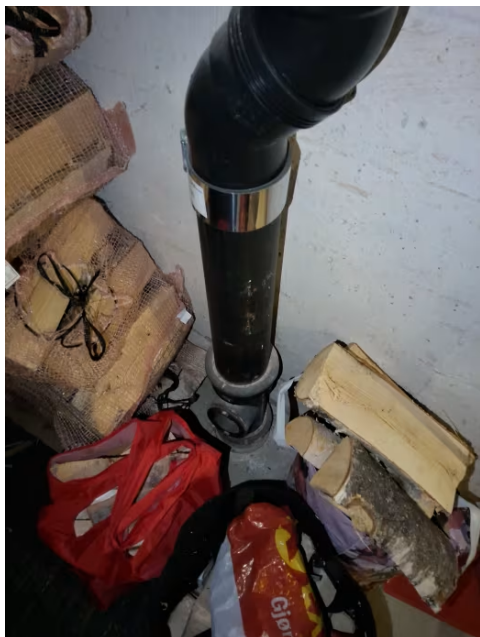
Stakeluke er plassert i felles kjeller.
