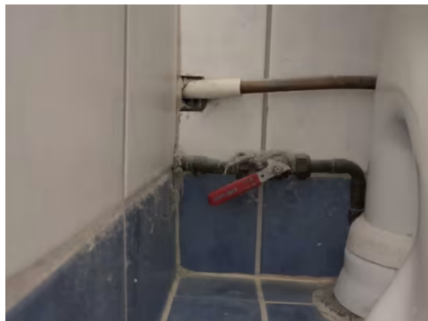
Rørgjennomføringer er ikke tett med membran/mansjetter.
