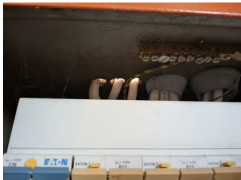
Det er åpninger rundt kabler fra sikringsskap.
