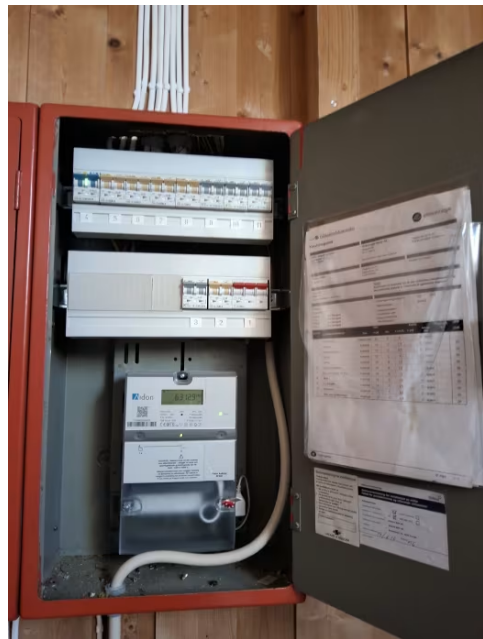
Sikringsskap er plassert i felles trappegang.
