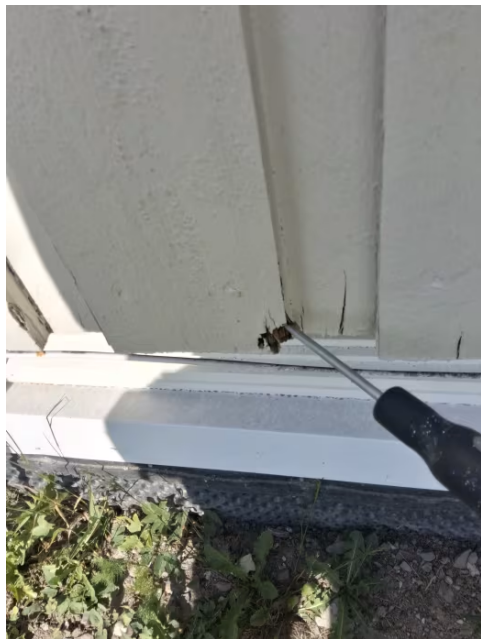
Det registreres enkelte råteskader på ytterkledningen.
