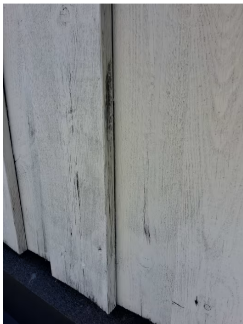
Kledning på rekkverk er værslitt.
