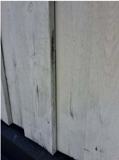
Kledning på rekkverk er værslitt.
