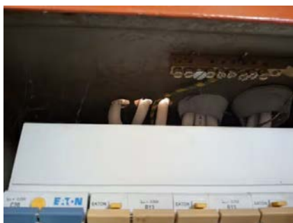
Det er åpninger rundt kabler fra sikringsskap.
