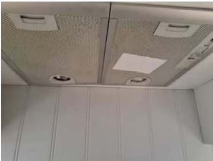
Avtrekkseffekten er testet med papir.
