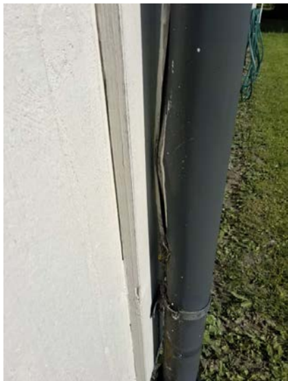
Utbuling på nedløpsrør.
