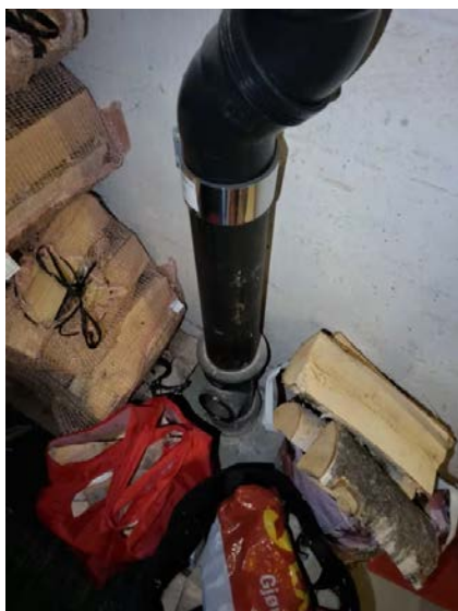
Stakeluke er plassert i felles kjeller.
