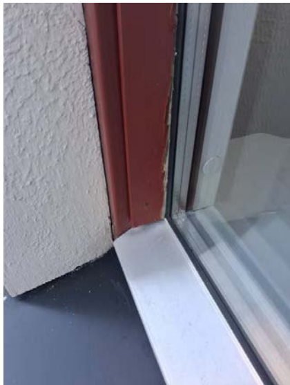
Enkelte vinduskarmer er værslitt.
