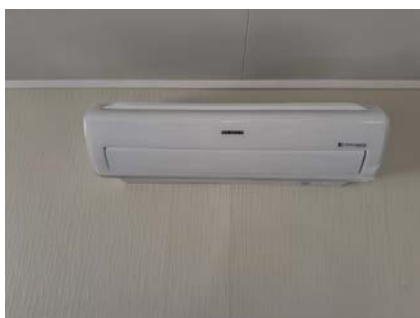
Varmepumpe er plassert i stue.
