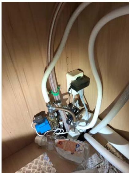
Vannrør av kobber og automatisk vannstoppeventil i kjøkkeninnredning.
