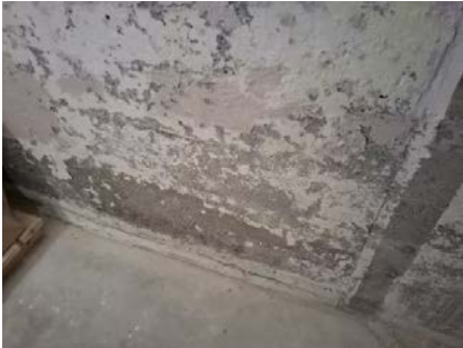
Salt/kalkutsalg på grunnmur.
