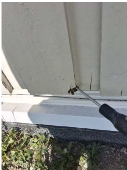
Det registreres enkelte råteskader på ytterkledningen.
