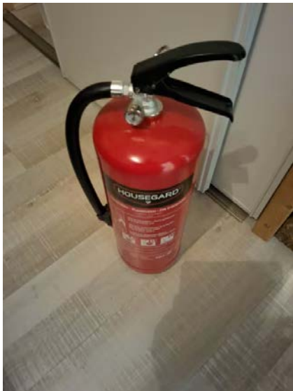
Brannslukningsapparatet er plassert på soverom.
