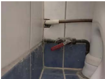
Rørgjennomføringer er ikke tett med membran/mansjetter.
