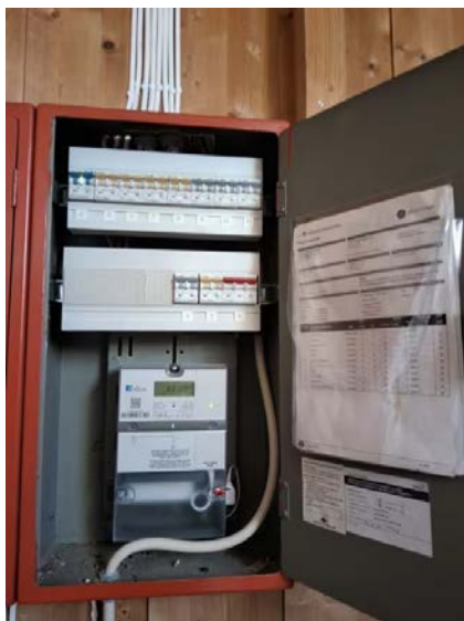
Sikringsskap er plassert i felles trappegang.
