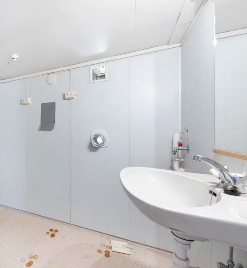
Vaskerom i 1. etasje.
