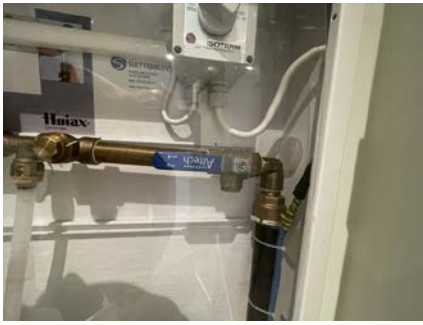
Stoppekran i rørfordelerskap.
