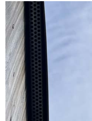
Lufteventil for lufting av takkonstruksjonen.
