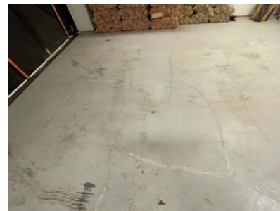
Sprekker i gulv.
