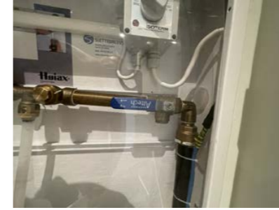
Stoppekran i rørfordelerskap.
