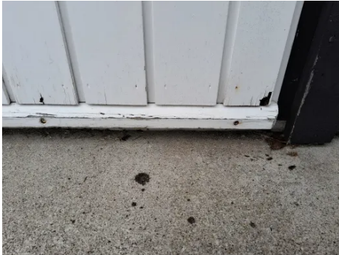
Boddør har påbegynnende råteskader.
