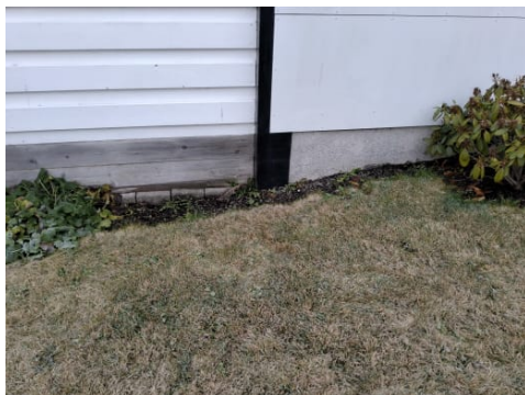
Fundamenteringen er ikke tilgjengelig for inspeksjon.
