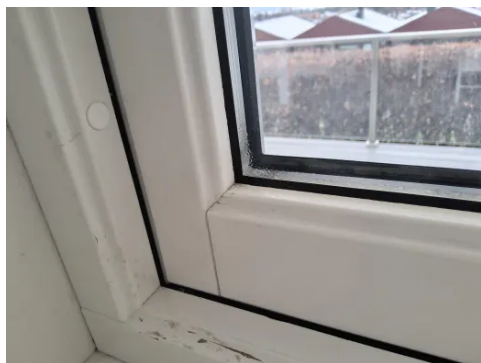
Det registreres tegn til kondens på enkelte vinduer.
