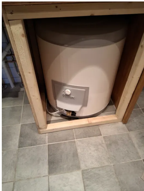
Gulvstående varmtvannsbereder plassert i kasse på bad.
