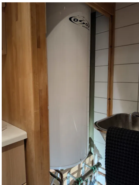
Vegghengt varmtvannsbereder plassert i kasse på bad.
