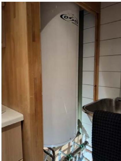
Vegghengt varmtvannsbereder plassert i kasse på bad.
