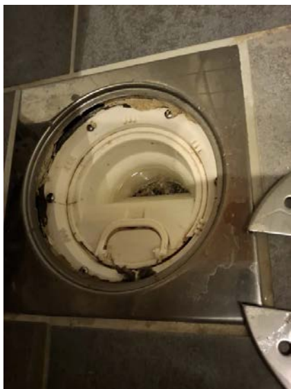
Overgang membran/klemring er ikke tilgjengelig for kontroll.
