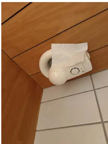
Avtrekkseffekten er testet med papir.
