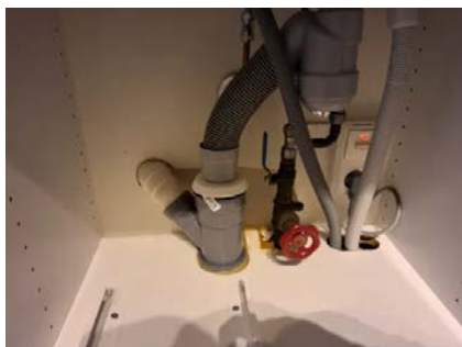
Leiligheten har synlige avløpsrør av plast.
