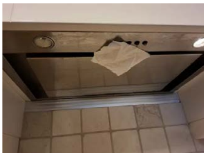
Avtrekkseffekten er testet med papir.
