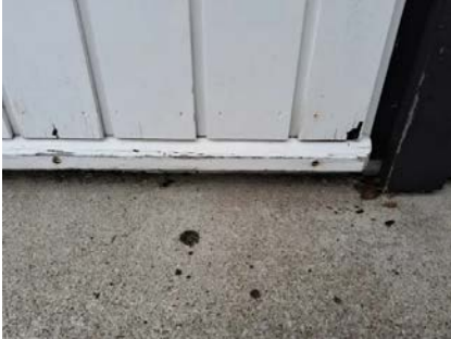
Boddør har påbegynnende råteskader.
