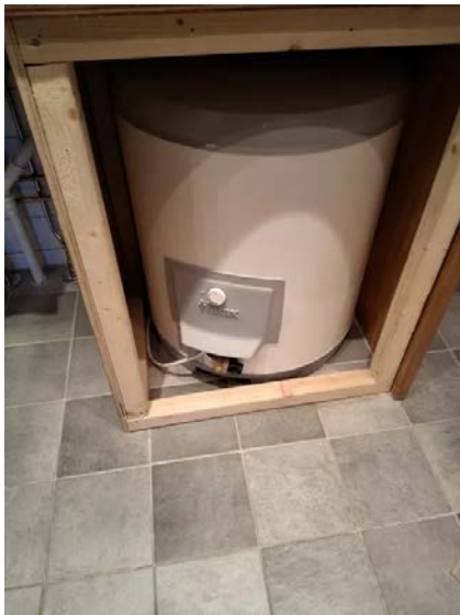
Gulvstående varmtvannsbereider plassert i kasse på bad.
