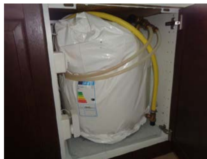
Varmtvannsbereder i skap på kjøkken.
