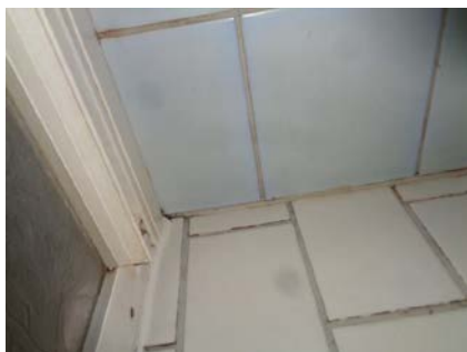
Sprekker og dårlige fuger.
