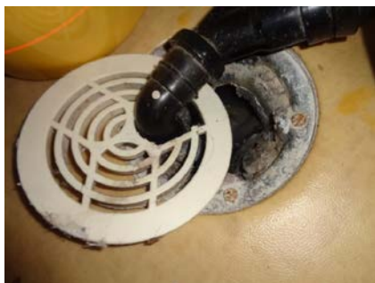
Plastsluk på vaskerom.
