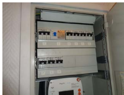
Sikringsskap i felles trapperom.
