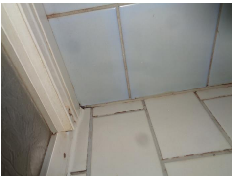
Sprekker og dårlige fuger.
