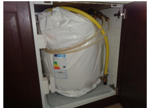
Varmtvannsbereder i skap på kjøkken.
