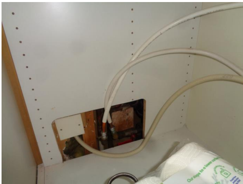
Stoppekran i luke i vegg i kjøkkenskap.
