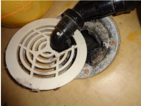
Plastsluk på vaskerom.
