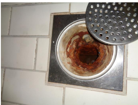
Støpejernsluk i dusjsone.
