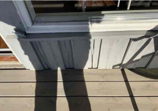
Kledning med tørkesprekker mm.
