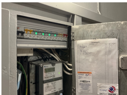
Automatsikringer i sikringsskap plassert i gang/fellesareal.
