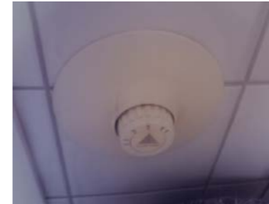
Regulering av gulvvarme.
