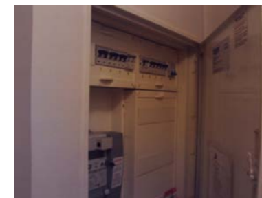
Sikringsskapet er plassert i bod.
