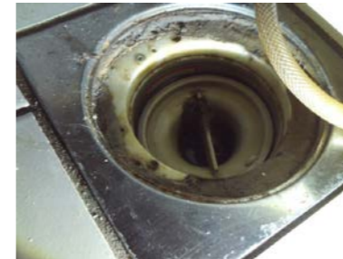
Sluk under dusjkabinett.
