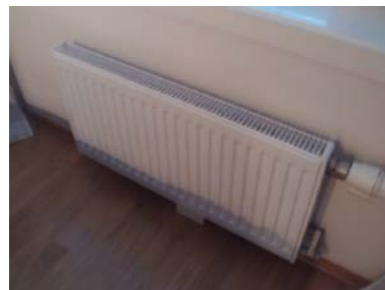
Radiator på soverom.
