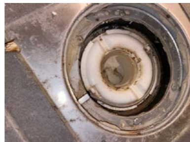
Sluk med synlig membran under klemring.
