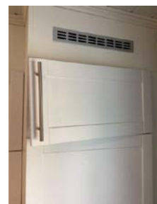
Løse hengsler som gjør at dør henger.
