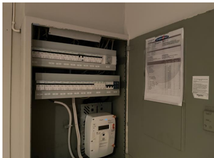
Sikringsskap i kjeller.
