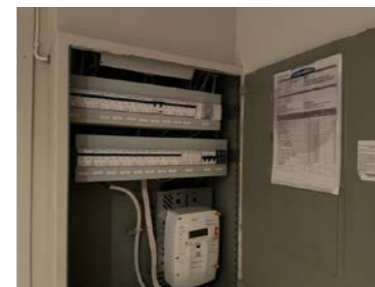
Sikringsskap i kjeller.
