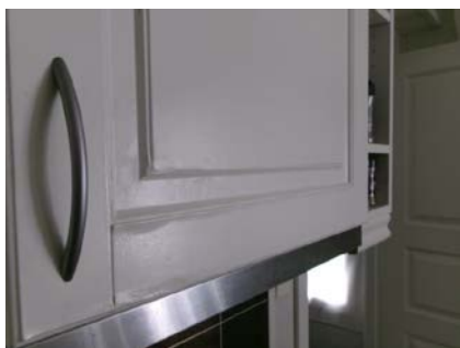
Skader på dør over avtrekksvifte.
