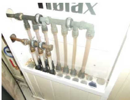
Rør-i-rør skap i underetasje, plassert i gang/teknisk rom.
