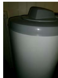
Underetasje, 200l bereder fra 2011
