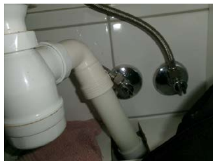
Rør i baderoms innredning.
