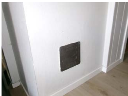
Feieluke plassert i gang, ved feiing blir det plassert stålplate under luken.
