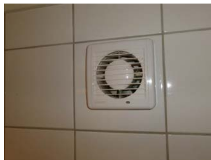
Via elektrisk styrt ventil.
