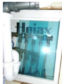
Rør-i-rør skap, plassert i kjøkken benk mellom kjøkken og bad i 1.etg.
