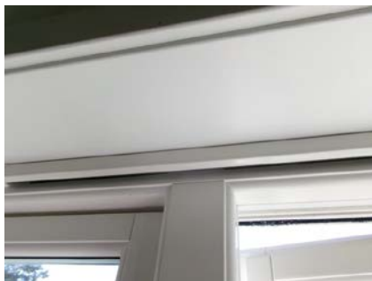
Ventiler i vinduer
