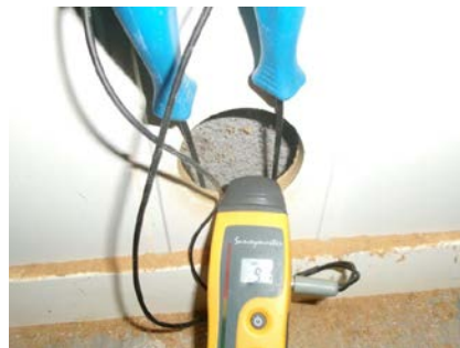
Hull ved dusj, målt 9 % fukt.
