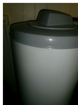
Underetasje, 200l bereder fra 2011
