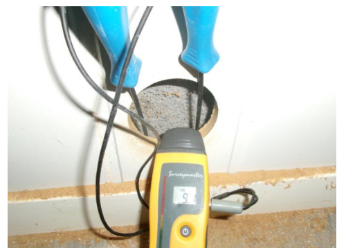
Hull ved dusj, målt 9 % fukt.
