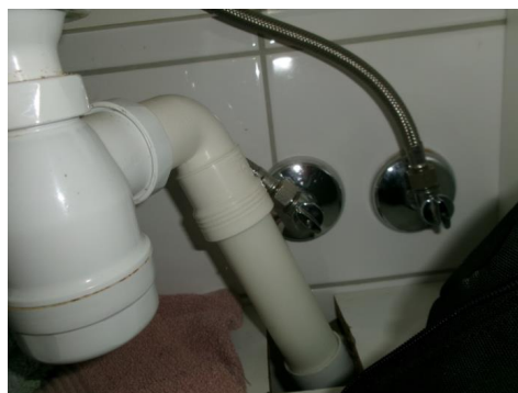
Rør i baderoms innredning.
