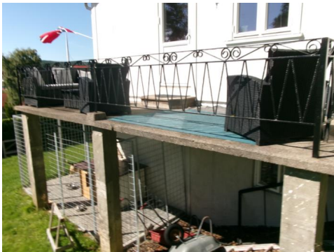
Terrasse, rekkverk med lav høyde og store åpninger mellom spiler.
