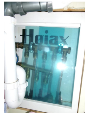
Rør-i-rør skap, plassert i kjøkken benk mellom kjøkken og bad i 1.etg.
