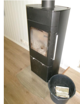
Vedovn med glassdør i underetasjen fra år 2022
