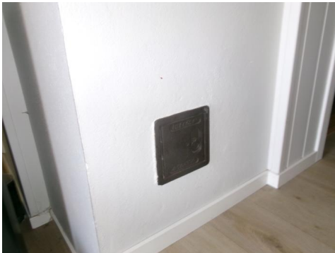
Feieluke plassert i gang, ved feiging blir det plassert stålplate under luken.
