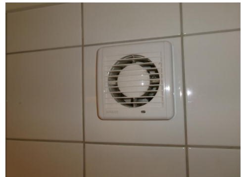
Via elektrisk styrt ventil.
