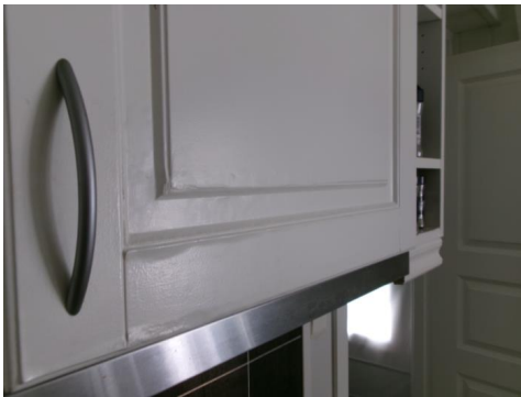
Skader på dør over avtrekksvifte.
