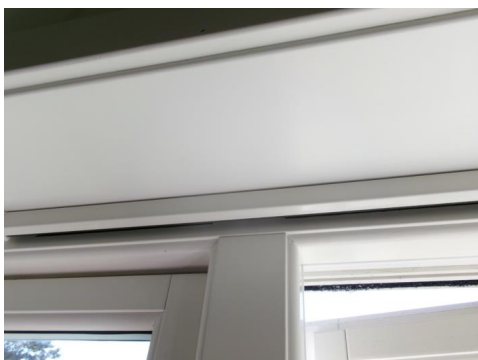
Ventiler i vinduer
