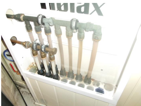
Rør-i-rør skap i underetasje, plassert i gang/teknisk rom.
