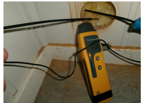
Vegg mot terreng, 16% fukt noe som er akseptabelt nivå.
