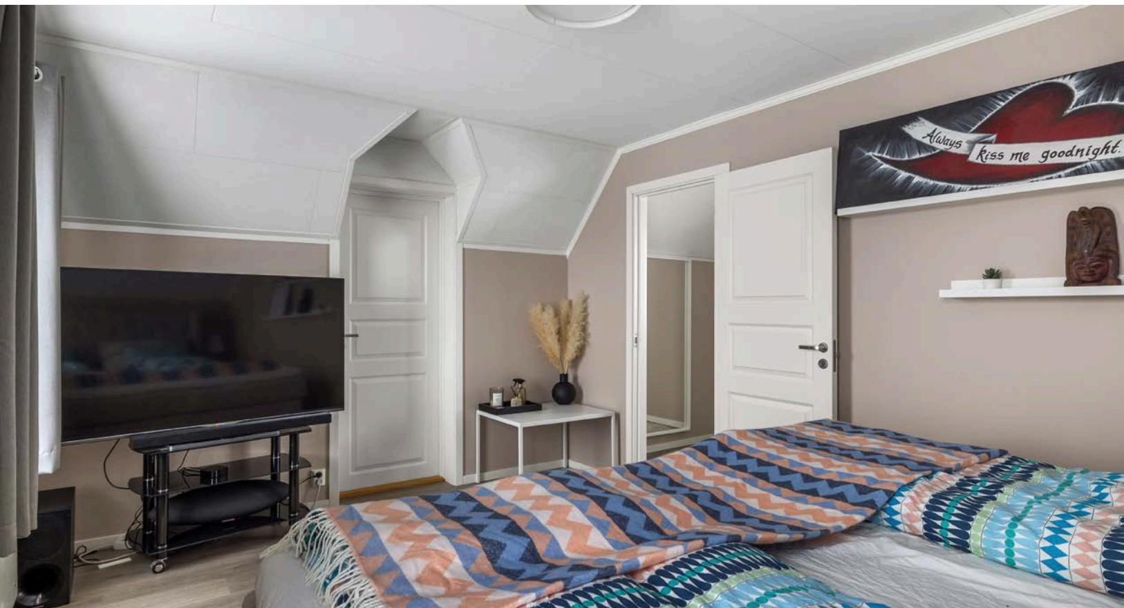
Soverommet har god standard med laminat på gulv, glatte overflater malt i en fin farge og skjult elektrisk anlegg.
