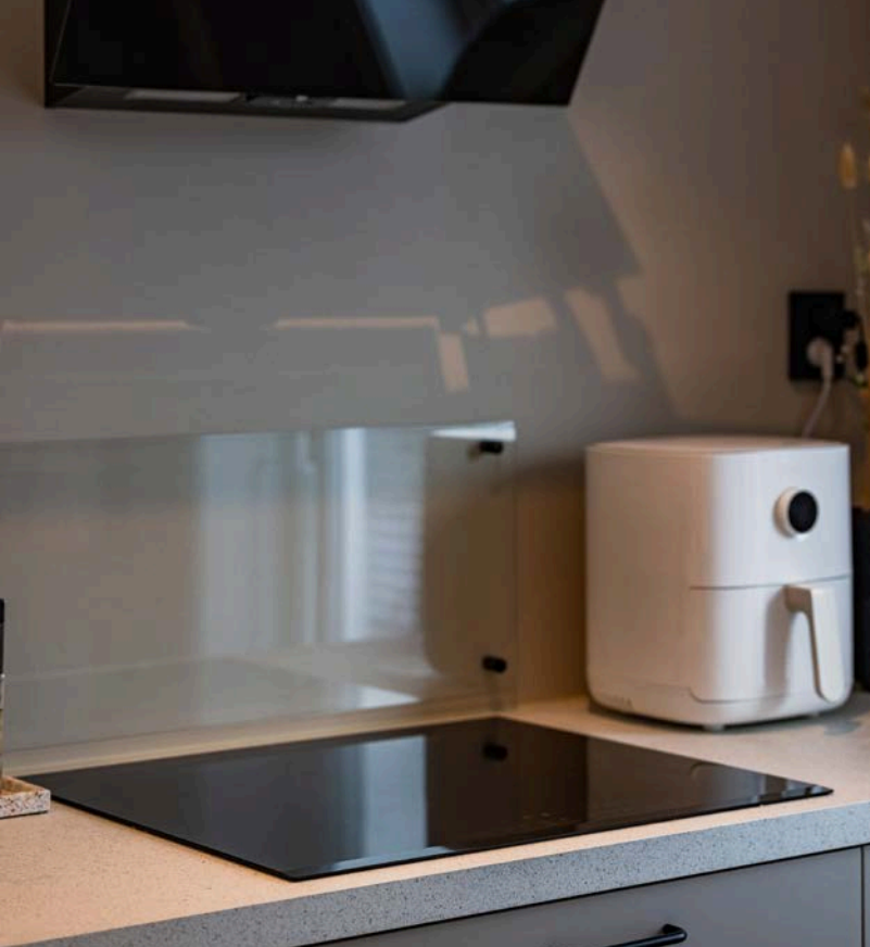
Kjøkkenventilator med avtrekk. Det er også montert komfyrvakt og lekkasjestopper.
