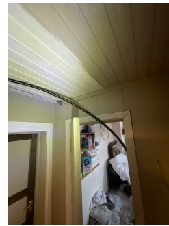
Vannledning går gjennom døråpninger.
