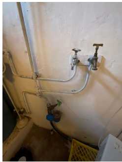
Stoppekran og vannmåler i vaskekjeller
