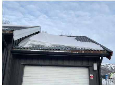
Tegn til nedbøy i takkonstruksjon over garasje
