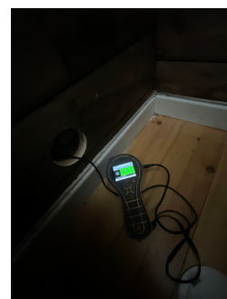
Fuktmåling i utforet vegg i kjellerstue.
