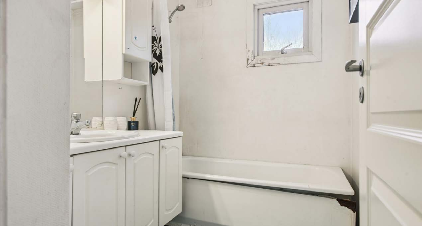
Eldre bad med behov for renovering.
