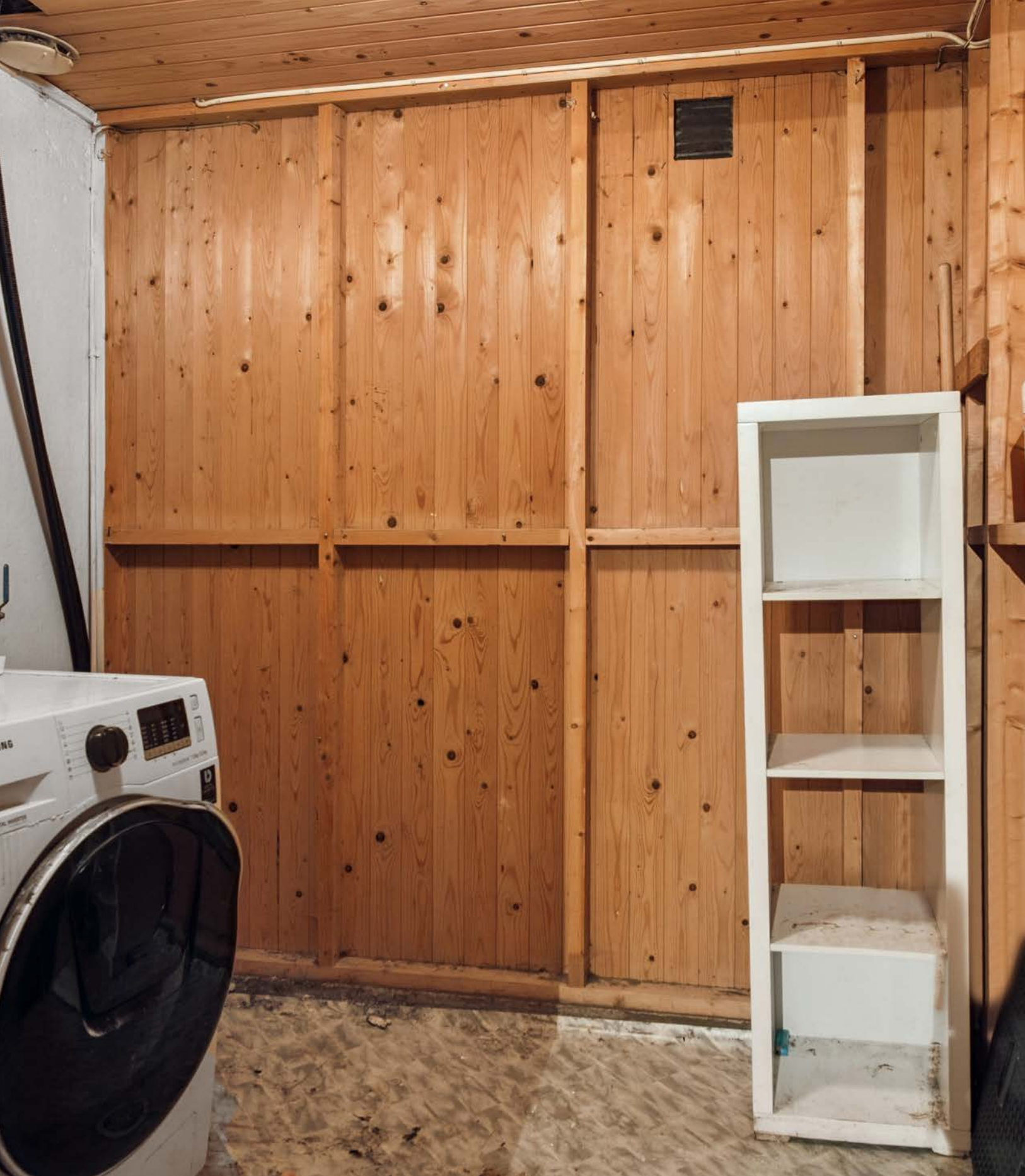
Vaskerom med opplegg for vaskemaskin, 200 liters varmtvannsbereder, stoppekran og vannmåler.
