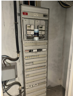
Sikringskap med automatsikringer.
