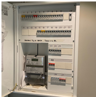
Sikringsskap med jordfeilautomatsikringer
