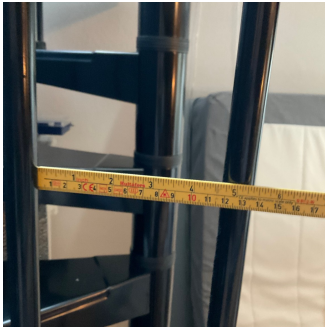
Avstand mellom spiler er over 10 cm
