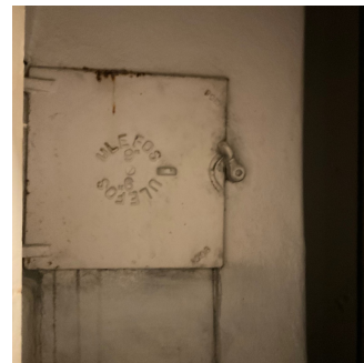
Feieluke på pipemur i kjeller, tilgang via deksel på innkassing ved nytt badetrom.
