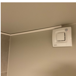
Elektrisk avtrekksvifte montert på yttervegg
