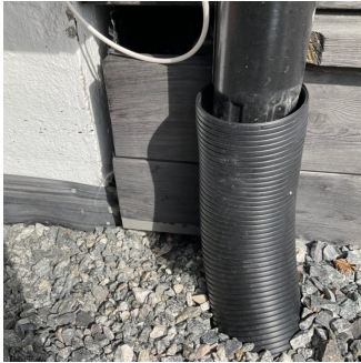
Taknedløp ført inn på fleksirør _ til terreng
