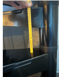
Vindeltrapp i tilbygg _ avstand mellom trinn er målt til 14 cm.
