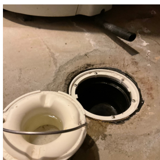
Utløp fra sikkerhetsventil til nyere innstøpt sluk
