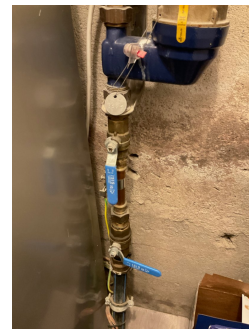
Vanninntak med stoppekraner og vannmåler
