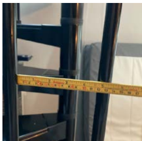
Avstand mellom spiler er over 10 cm
