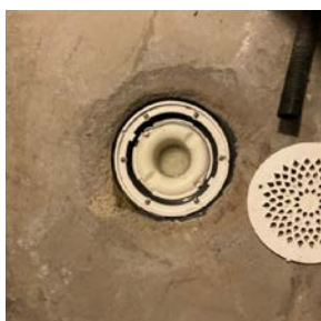
Nyere sluk av plast i gulvstøp - Rør fra fordelerskap / lekkasjevarsler
