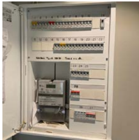
Sikringsskap med jordfeilautomatsikringer
