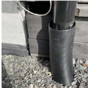
Taknedløp ført inn på fleksirør _ til terreng
