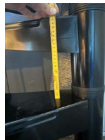
Vindeltrapp i tilbygg _ avstand mellom trinn er målt til 14 cm.
