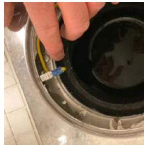
Sluk i nedsenket dusjsone er av plast med klemring. Påført smøremembran ved duk / mansjett
