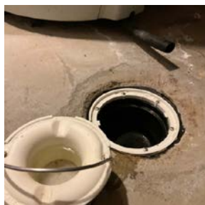
Utløp fra sikkerhetsventil til nyere innstøpt sluk
