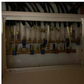
Fordelerskap i kjeller / teknisk rom
