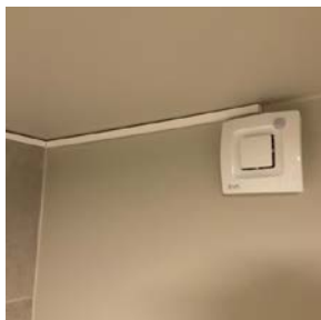
Elektrisk avtrekksvifte montert på yttervegg
