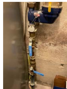
Vanninntak med stoppekraner og vannmåler
