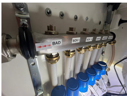
Fordelersystem- rørsystem i teknisk rom.
