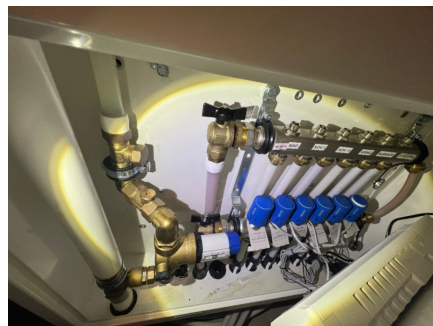
Fordelersystem- rørsystem i teknisk rom.
