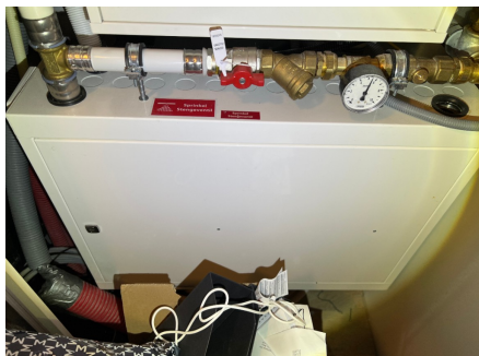
Fordelersystem- rørsystem i teknisk rom.
