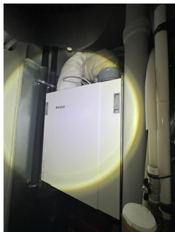
Ventilasjonsanlegg i teknisk rom.
