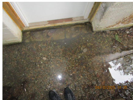
Fritt vann i kjellernedgang ved besiktigelsen.
