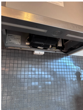
Fettfilteret manglet på befaringdagen.
