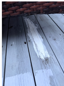
Råteskadet terrassebord er kosmetisk utbedret med en ukjent type sparkel/fyllmasse
