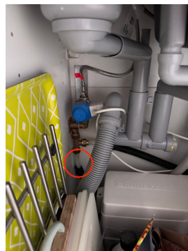
Det mangler tettemuffer mellom varerør og vannrør på kjøkkenet (2 steder)
