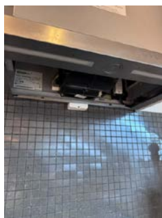
Fettfilteret manglet på befaringdagen.
