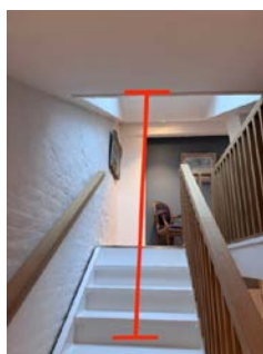
Lav høyde mellom trapp og innvendig tak.
