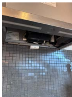
Fettfilteret manglet på befaringsdagen.
