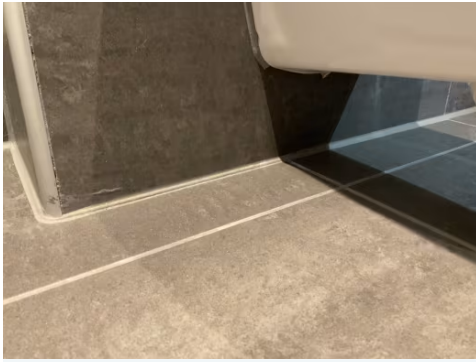
Manglende drensåpning for sisterner
