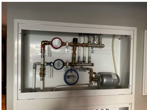
Fordelerskap til vann.
