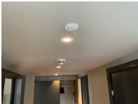
Brannvarsler og sprinkel.
