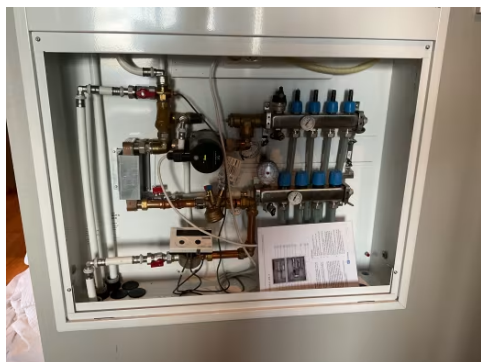
Fordelingskap til vannbåren varme
