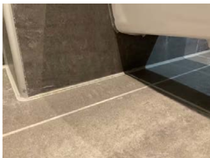
Manglende drensåpning for sistene
