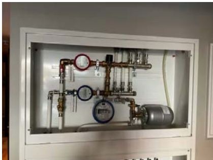
Fordelerskap til vann.
