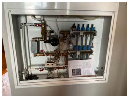
Fordelingskap til vannbåren varme
