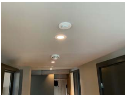
Brannvarsler og sprinkel.
