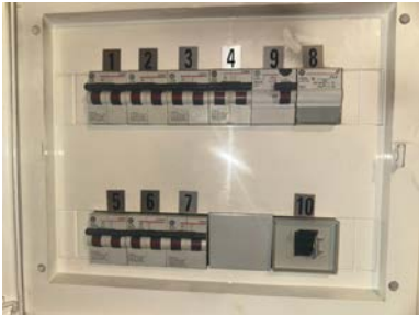
Sikringsskap med automatsikringer.
