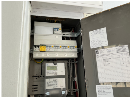
Automatsikringer i sikringskap plassert i gang/fellesareal.
