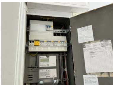
Automatsikringer i sikringskap plassert i gang/fellesareal.
