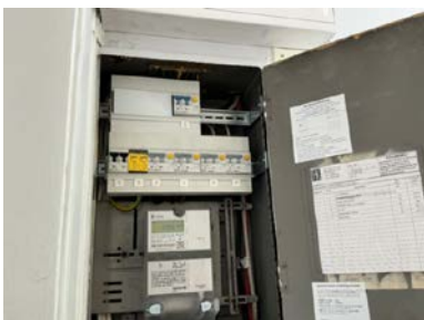
Automatsikringer i sikringskap plassert i gang/fellesareal.
