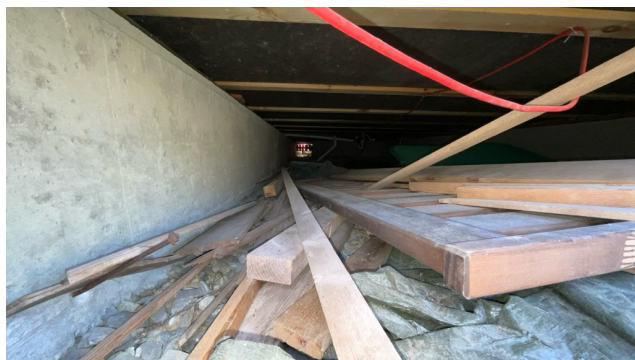
Besiktigelse av kryprom. Det er manglende fuktsperre på bakken.
