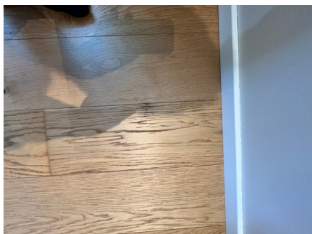
Merke i gulv på stue
