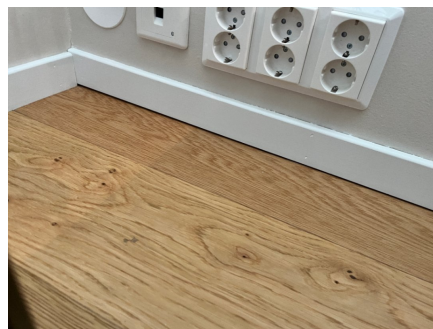
Glippe mellom gulvlist og gulv i stue
