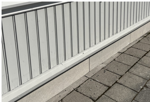
Noe sprekker i nedkant på bordkledning
