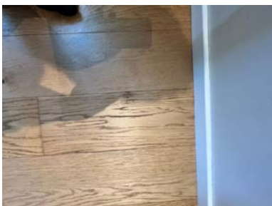
Merke i gulv på stue
