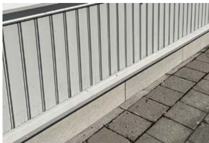
Noe sprekker i nedkant på bordkledning
