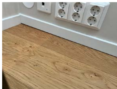
Glippe mellom gulvlist og gulv i stue
