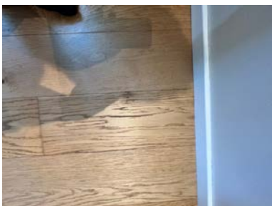
Merke i gulv på stue
