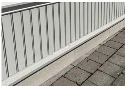
Noe sprekker i nedkant på bordkledning
