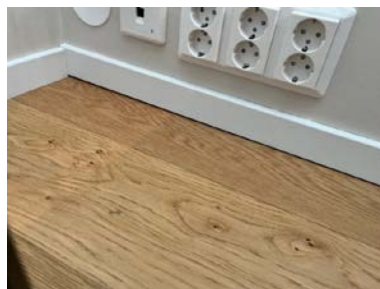
Glippe mellom gulvlist og gulv i stue
